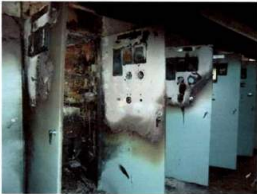
高压電源盤 現場写真
