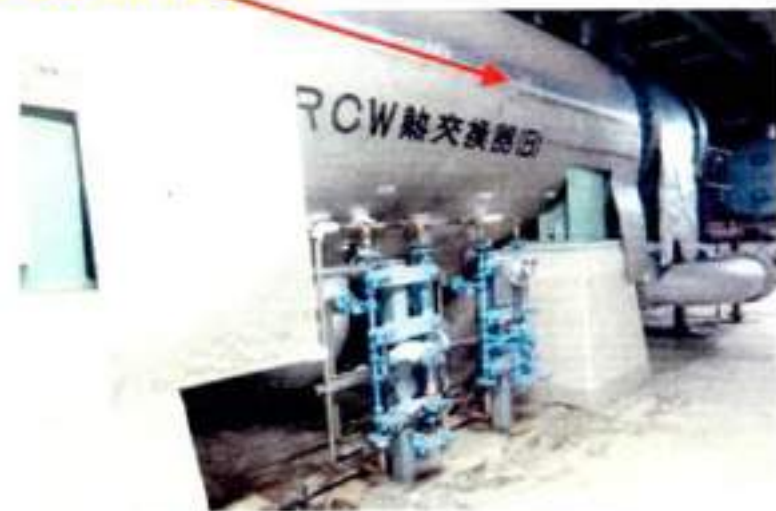
原子炉補機冷却水B系熱交換器室
