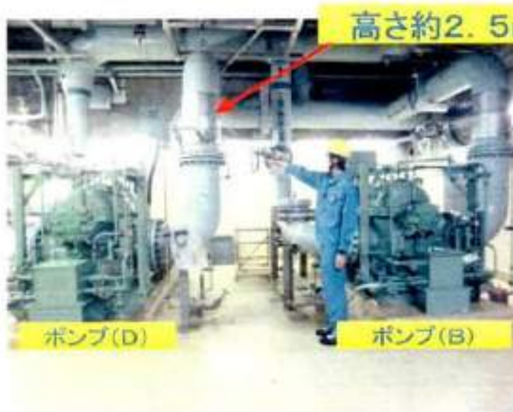
原子炉補機冷却水B系ポンプ室
