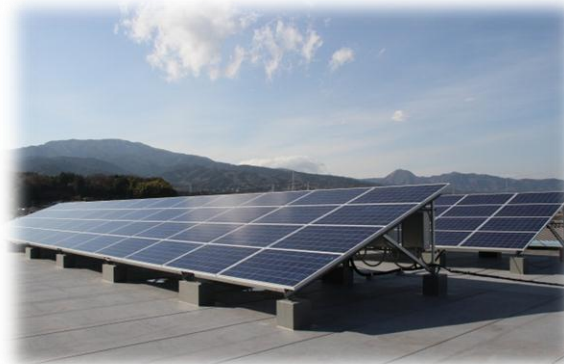
富水小学校に設置された太陽光発電設備
