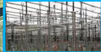
電圧変換送致
